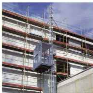
Personen- und Lastenaufzüge
