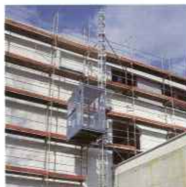
Personen- und Lastenaufzüge
